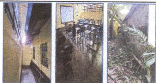
Foto 6: (9.) Pintura en muros exteriores e interiores, por deterioro de la pintura
