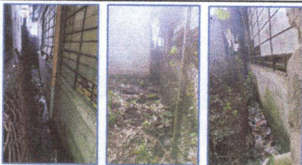
Foto 5: (8.) Cuneta de concreto en donde se acumula el agua
