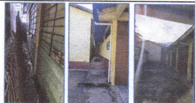
Foto 4: (7.) Canales y bajadas de agua pluvial quebrados
