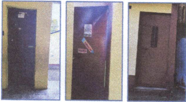
Foto1: (4.) Puertas de metal deterioradas
